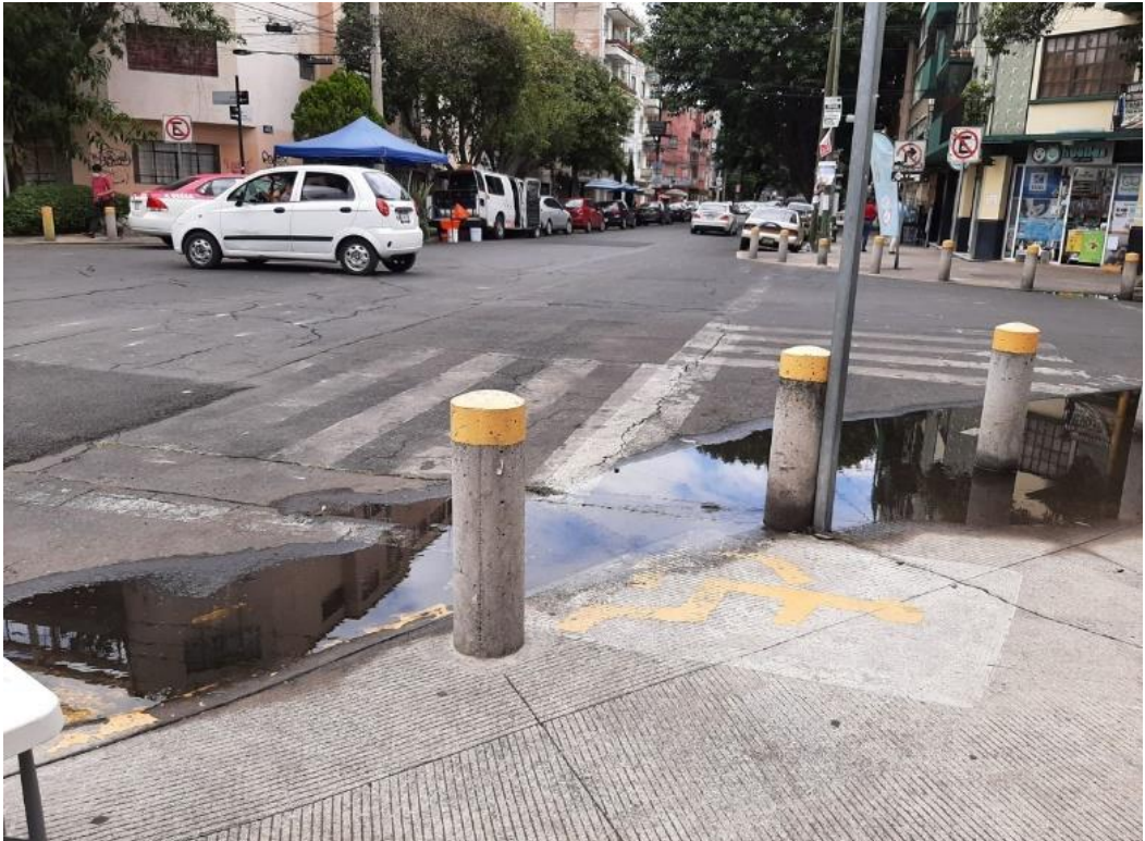
Figura 1. Rampa comprometida por el agua estancada
